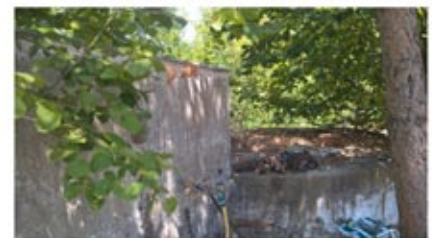
Poço com água e sistema de rega instalado
